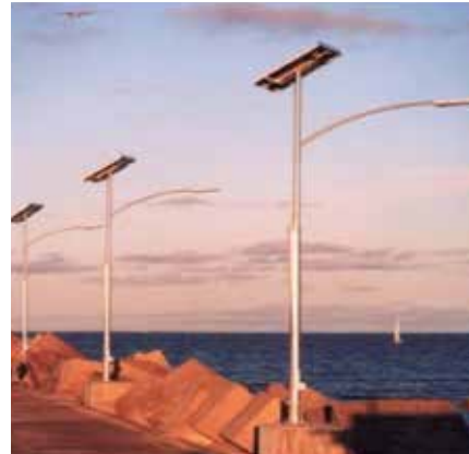
Şekil 4 - Güneş enerjisi ile aydınlatma Figure 4 - Solar energy lighting
